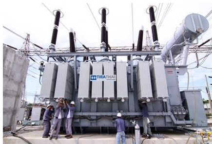
Figure 1 หม้อแปลงไฟฟ้า
