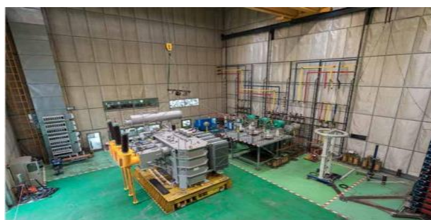
Figure 4 ห้องที่ใช้สำหรับการทดสอบหม้อแปลงไฟฟ้า
