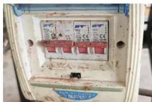
(ฉ) แผงควบคุม
